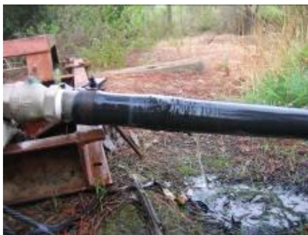
Fuga en un pozo de riego en zona forestal
