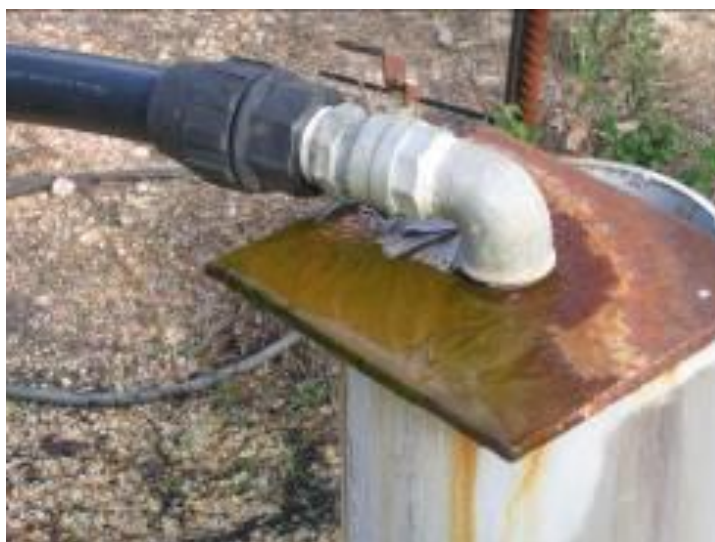
Toma en un pozo ilegal
