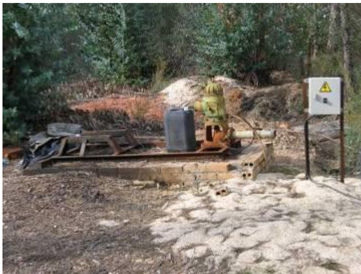
Pozo ilegal en la Cabecera de la Rocina
